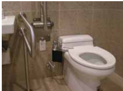
追加設置したオストメイト対応器具
