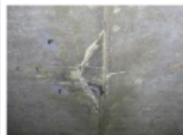
目地沿いの 半月状ひびわれ
