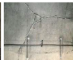
ブロック化した ひびわれ
