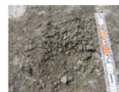
床版表面の砂利（土砂）
