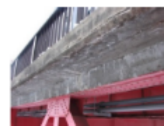
遊離石灰の 滲み出しや漏水
